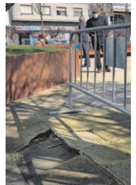
Los daños son en San Roque
