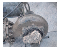
Bomba atascada por toallitas.
